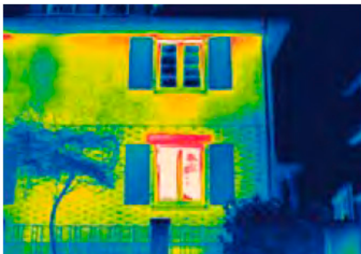
Abbildung 9: Thermografie-Aufnahme einer Wärmebrücke im Bereich des Fenstersturzes, dena 2008
