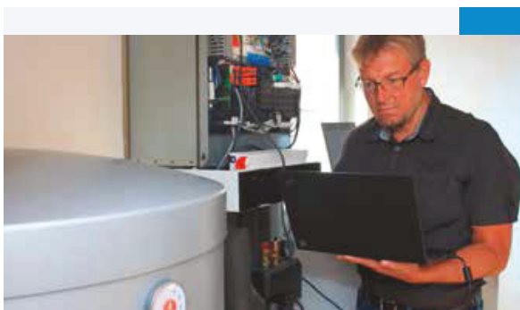
Ein Projektmitarbeiter prüft mithilfe eines Laptops das Wärmepumpensystem zur Erprobung der Lastverschiebungsstrategien.
