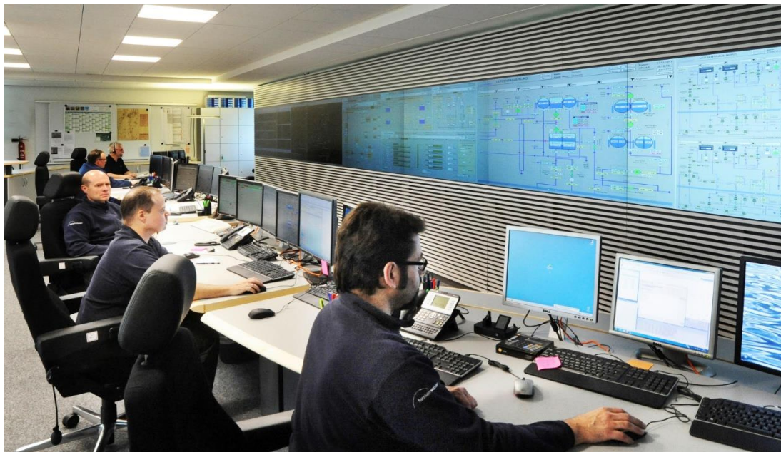
Abb. 4.4 Zentrale Leitstelle für die Überwachung und Steuerung wasserwirtschaftlicher Anlagen
