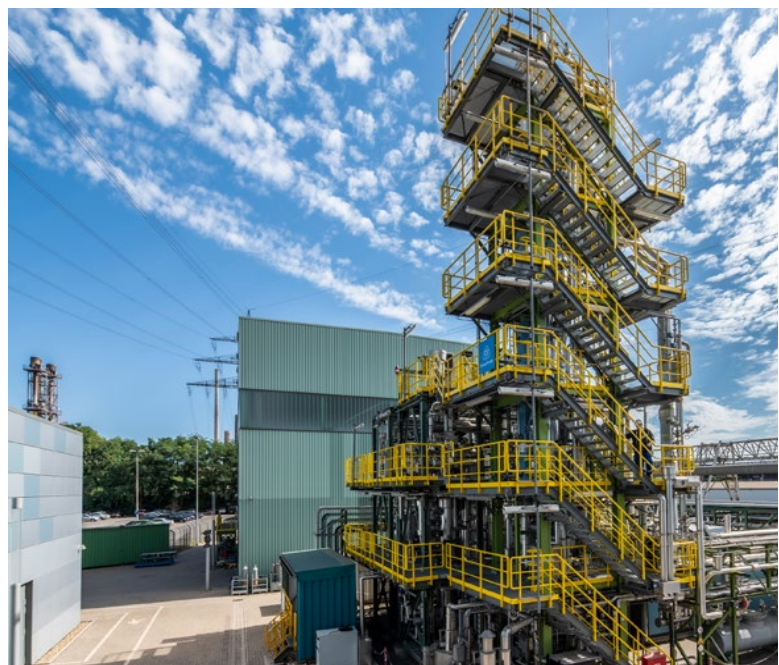
Das „Carbon2Chem“-Technikum am ThyssenKrupp-Standort in Duisburg
