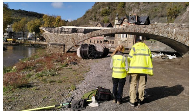
Von der Flutkatastrophe zerstörte Eisenbahnbrücke bei Ahrweiler
