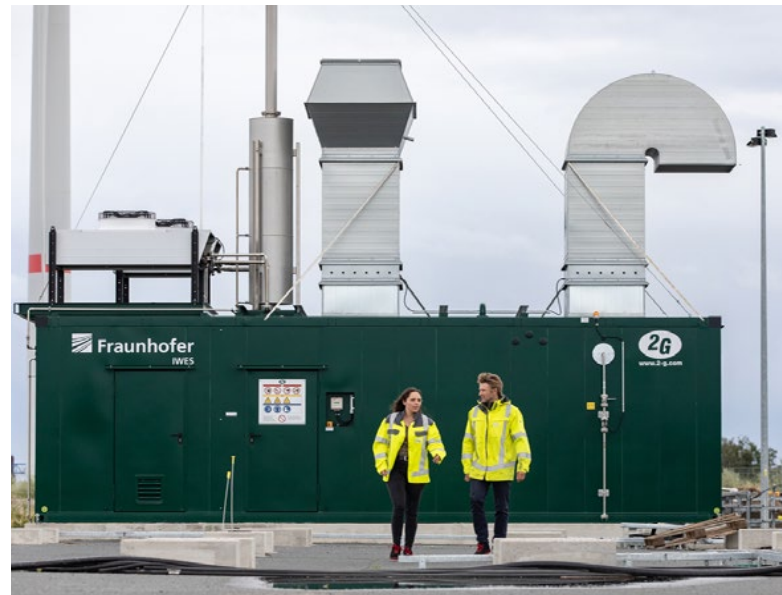
Das Hydrogen Lab Bremerhaven des Fraunhofer-Instituts für Windenergiesysteme IWES
