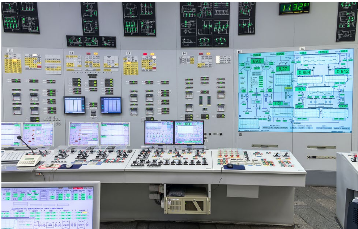
Kontrollraum in einem Kernkraftwerk
