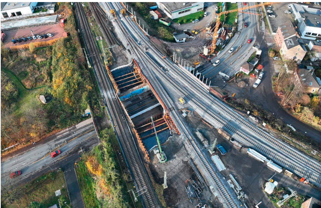
Abbildung 10 Dinslaken – EÜ Weseler Straße – Vorbereitung Neubau Widerlager nach Abriss Bestandsbauwerk Foto: Deutsche Bahn AG
