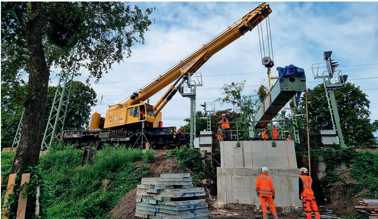
Abbildung 7 Aufbau einer Signalbrücke Foto: Ute Göldner
