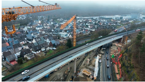
Abbildung 34 Blick auf die Baustelle der Talbrücke Sechshelden auf der A 45, Blickrichtung Hanau Foto: Die Autobahn GmbH des Bundes, Niederlassung Westfalen
